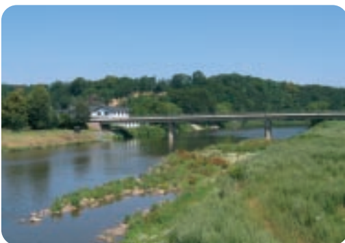
Auflandungen im rechten Uferbereich und vorgezogene Böschung zwischen den Brücken
