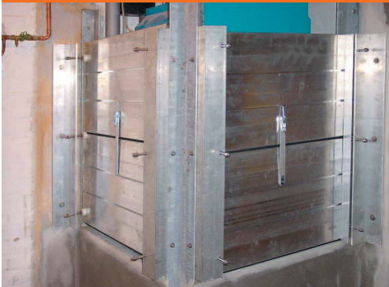
Sicherung eines Heizungsbrenners
